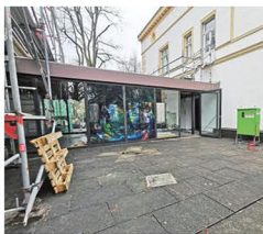
Das Foyer, das auch als Verbindung von Alt- und Neubau dient, wird erheblich größer. Bis zur Treppe weitet der Raum sich aus, der so auch eine Aufenthaltsqualität erhalten soll. Foto: Hartmut Horstmann
